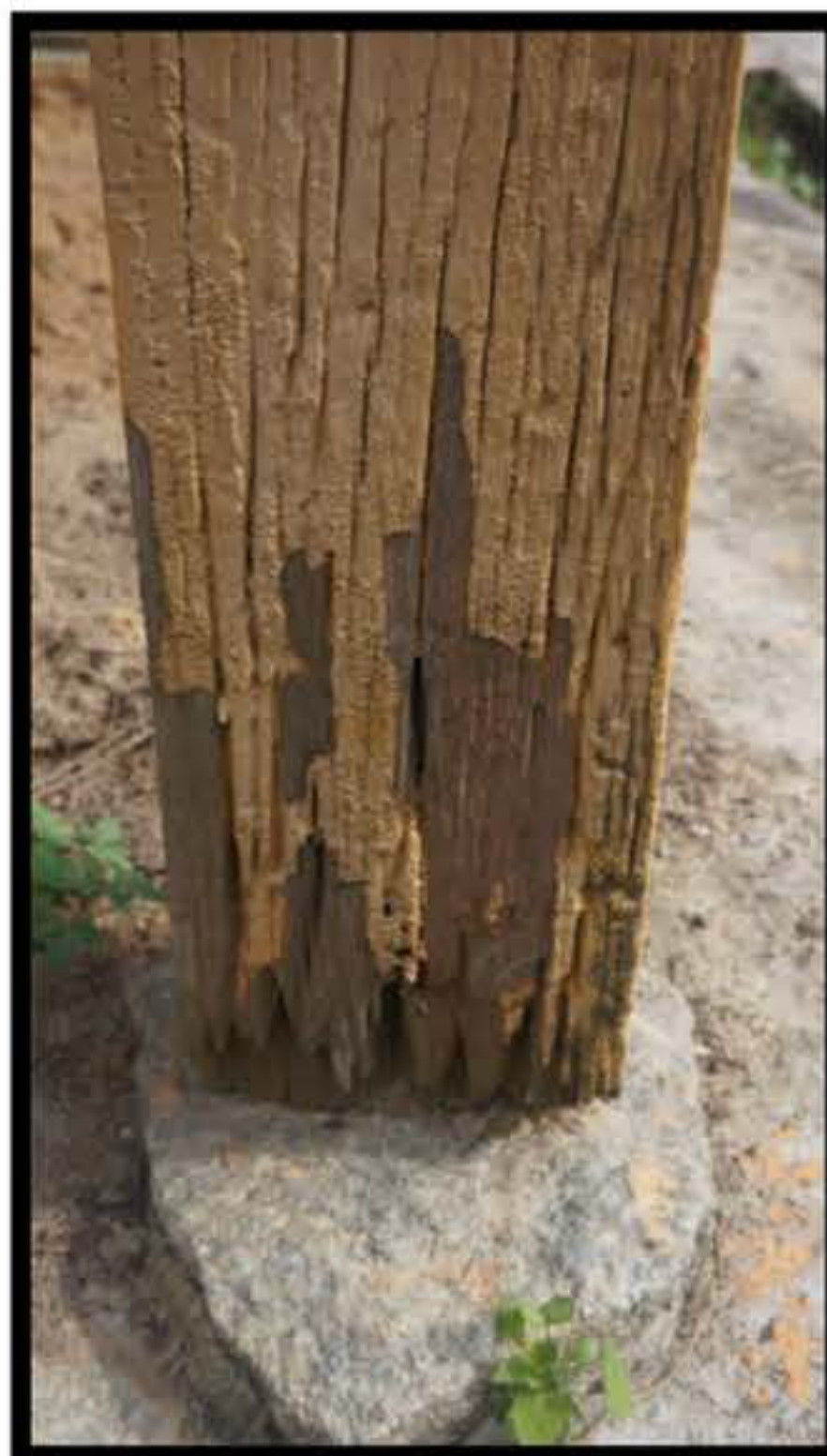
Gambar 43 : keretakan pada bahagian kaki tiang
